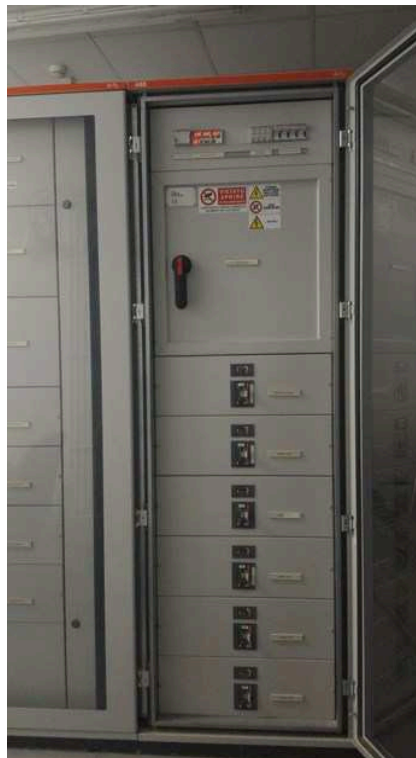
Interruttore generale energia elettrica
