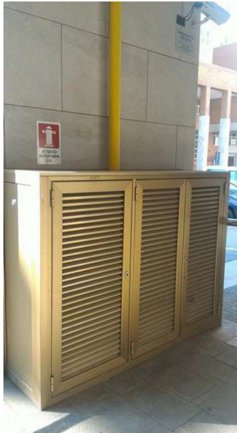
Attacco autopompa vvf
